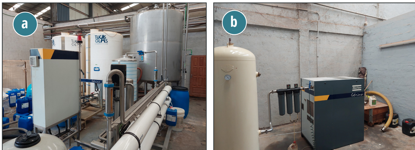
FIGURE 9 : Unités de production d'eau osmosée (a) et d'air comprimé (b)
